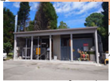
木質バイオマスボイラー
